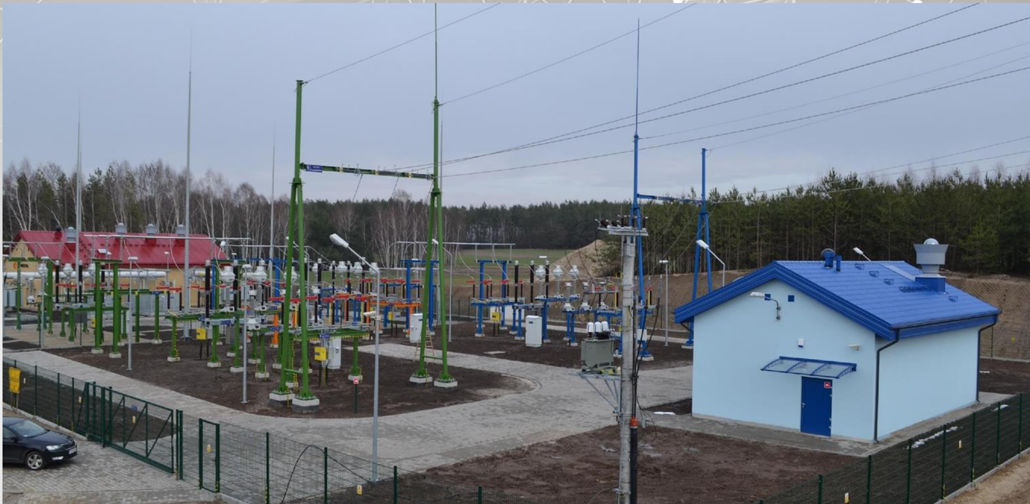
Stacja GPZ Ryłsk
