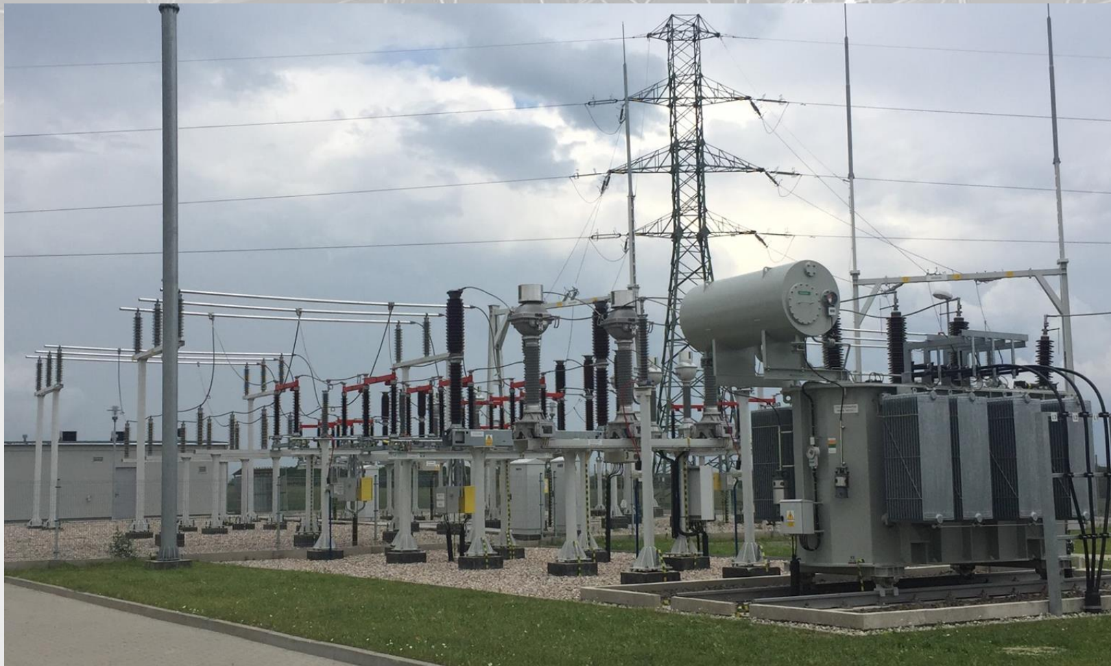
Stacja GPO Giednia
