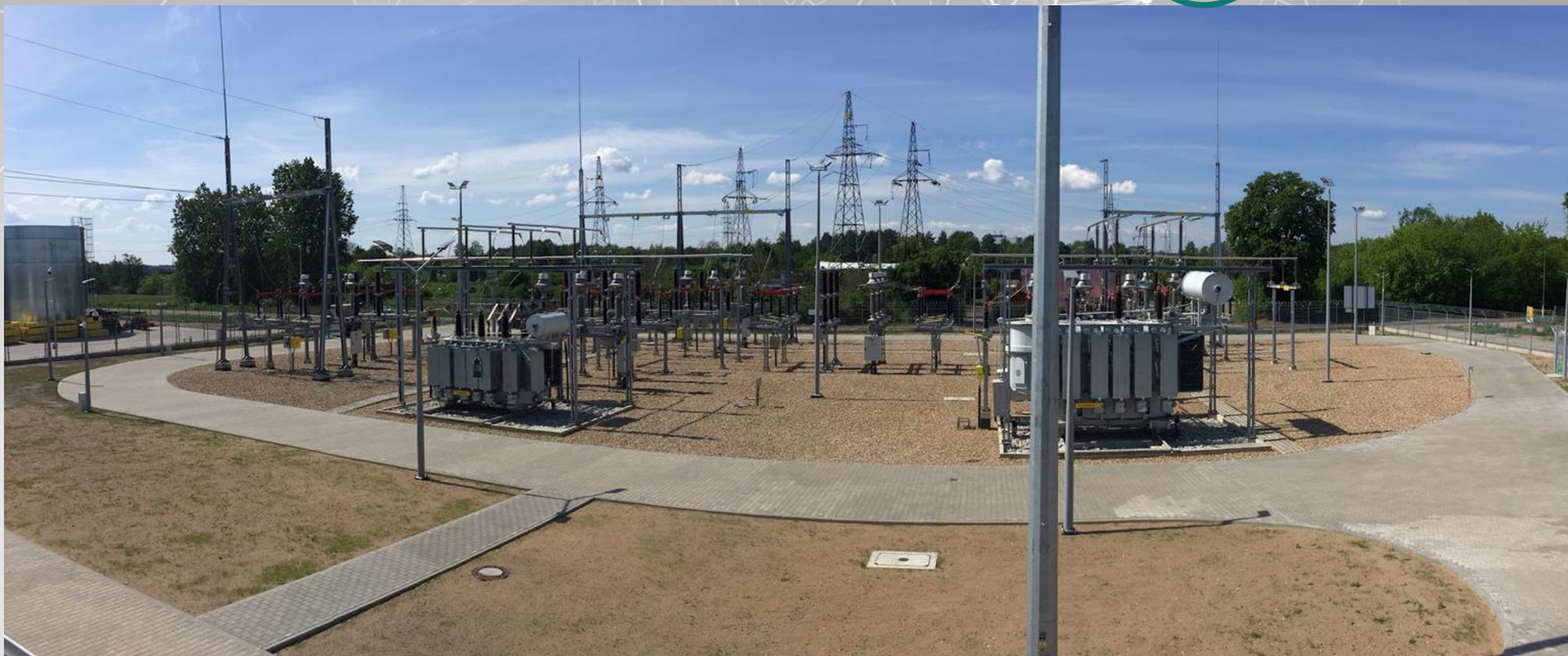
Stacja GPZ Piła Południe
