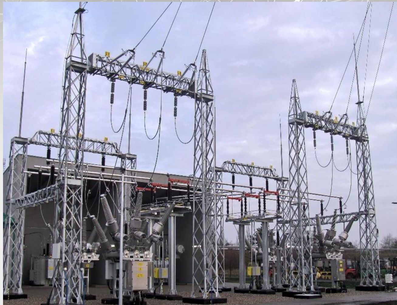
Stacja GPZ Toruń
