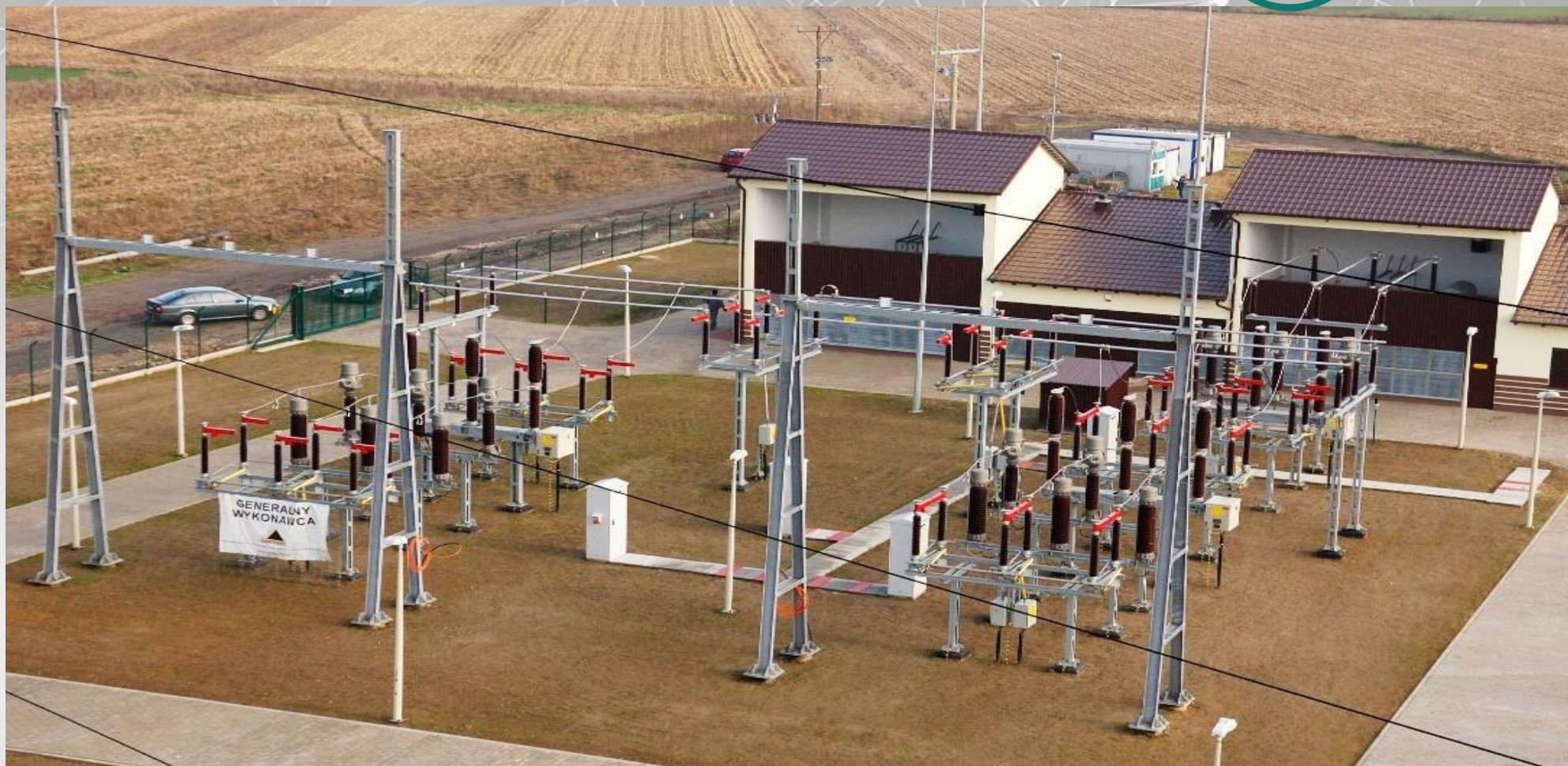
Stacja GPZ Ociąż
