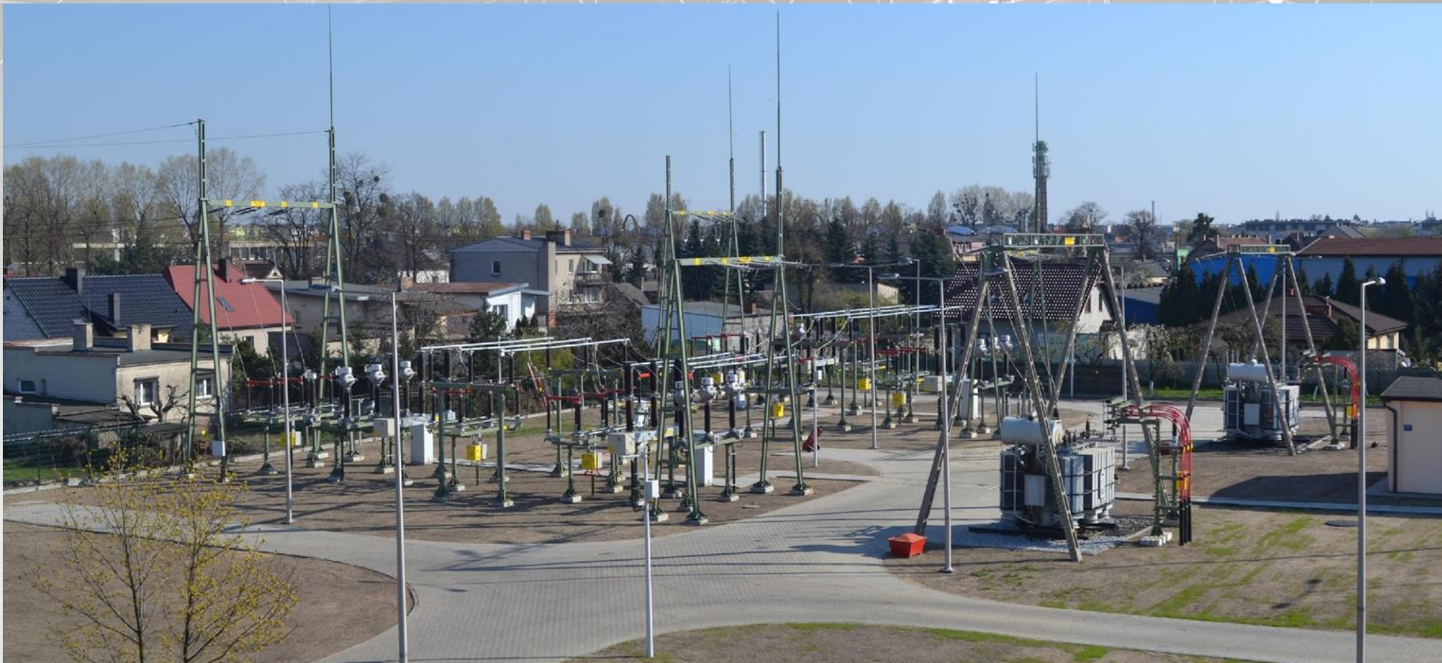
Stacja GPZ Ostrów
